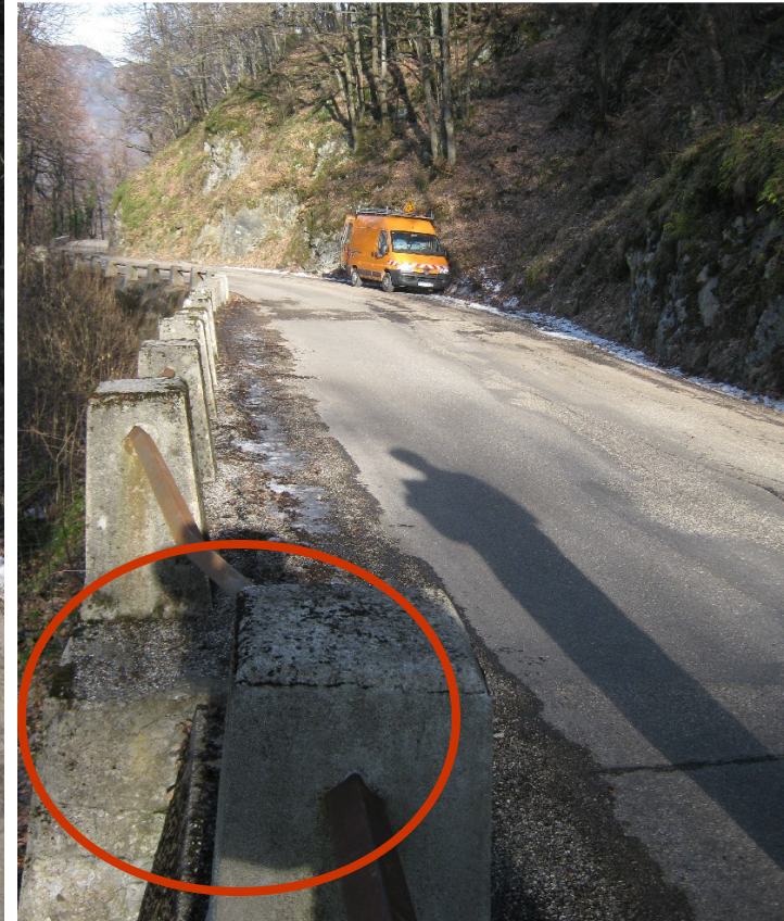
Décalage marqué de la tête de mur
