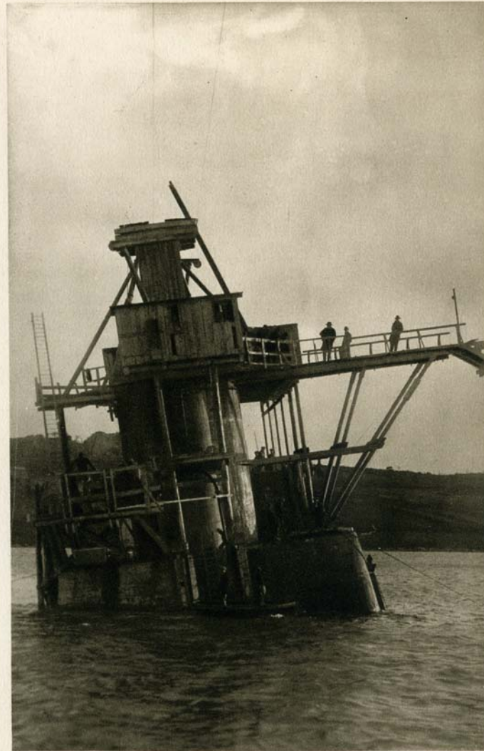
Sous l'influence d'un soufflage partiel, le caisson s'incline pour quitter la première pile dont la fondation est terminée.
