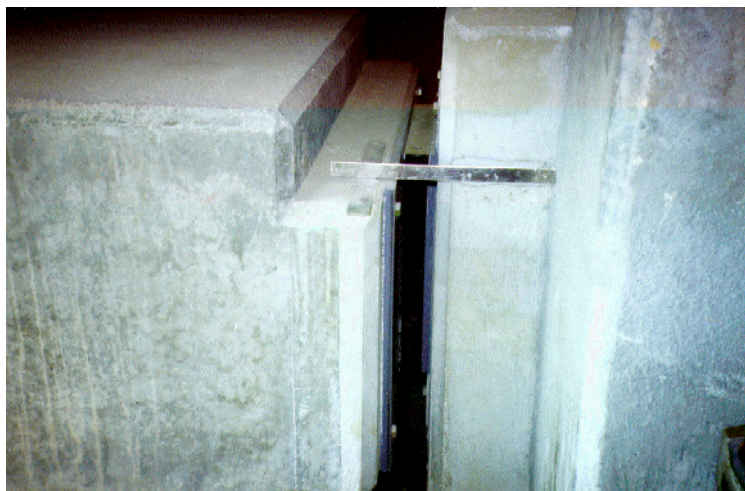
Figure 2.5 : exemple d'un réglet de suivi de déplacement (appareil d'appui vertical en butée antisismique)
