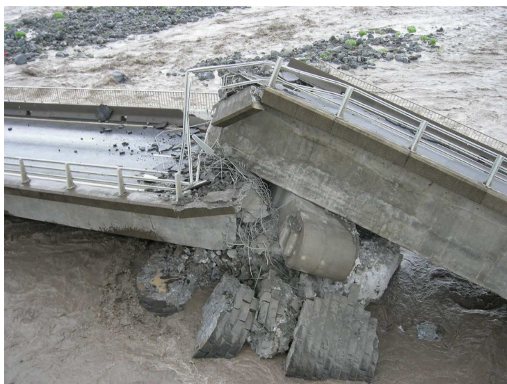
Effondrement du pont sur la rivière St-Etienne à la Réunion suite au passage du cyclone Gamède (2007)
