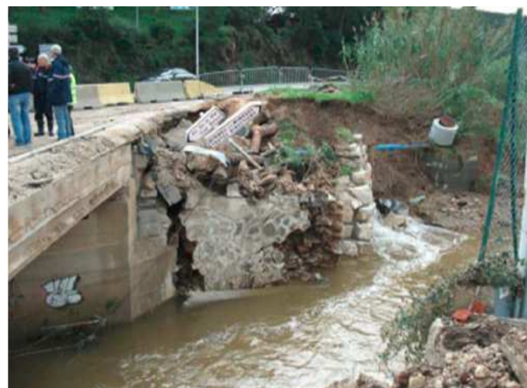
Effondrement d'une berge du pont sur le Batailler au Lavandou (83) suite aux inondations du Var (2014)
