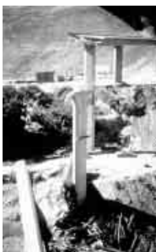
Photo 2 : Echappement dû à une courbure importante (San Fernando, 1971)
