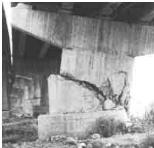
Photo 5 : Rupture par effort tranchant
