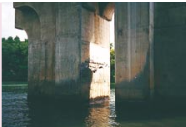
Photo 3 : dégradation de la pile P_2
