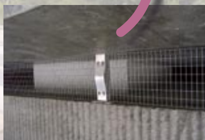
Photos 15 : butée parasismique de blocage latéral en culée rive gauche et grillage anti-intrusion
