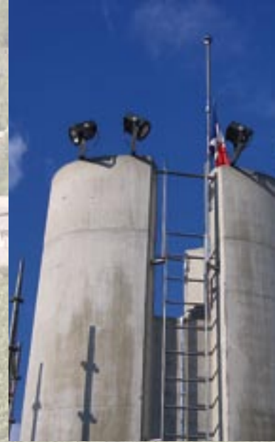
d) paratonnerre et éclairage en tête de mâts
