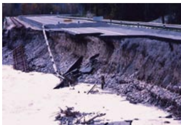
Photo 1 : dégâts occasionnés lors de la crue de 1994
