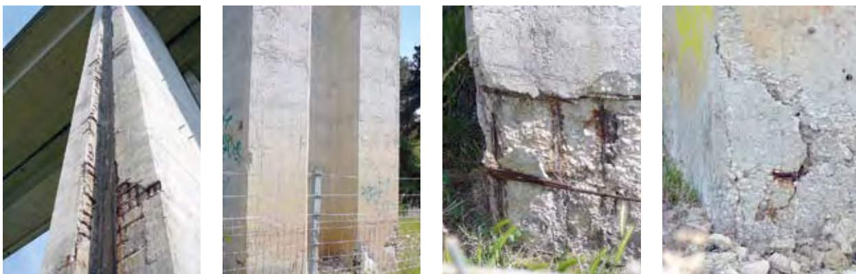
Figure 10 : pont 1 de l'A24, éclatement du béton d'enrobage – Source : CETE Méditerranée, Sétra
