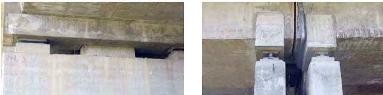
Figure 9 : appareils d'appui fréquemment rencontrés sur les ouvrages de l'A24 (néoprènes et crémaillères) – Source : CETE Méditerranée, Sétra
