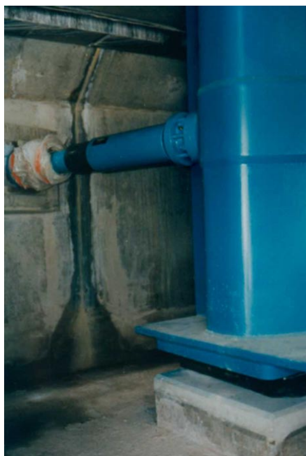
Amortisseur longitudinal sur culée
