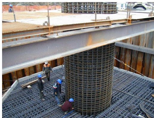
Figure 11 : Densité de ferrailage très importante en pied de fût de pile (source : Cerema / DTerMed)
