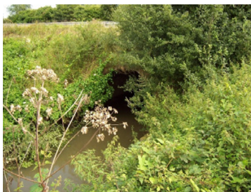
L'ouvrage n'est ni accessible ni visible en raison de la végétation qui envahit les abords et de la présence d'un cours d'eau.
