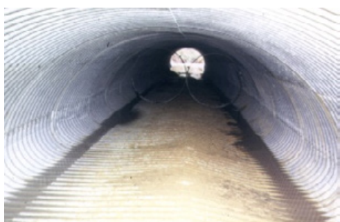
Inversement de la courbure du radier d'une buse métallique
