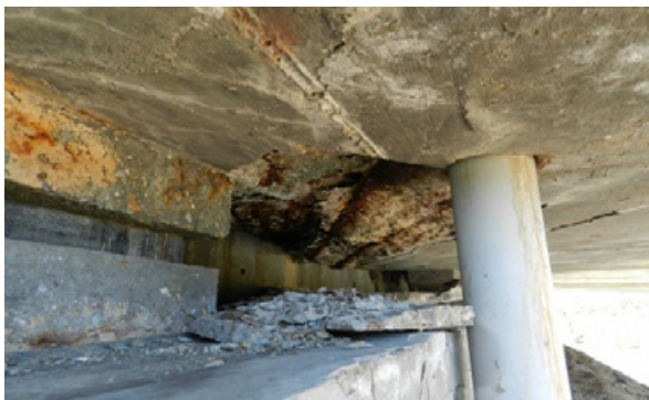
Éclatements de béton avec réduction des sections d'aciers
