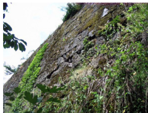
Bombement de maçonnerie avec disjointoiement
