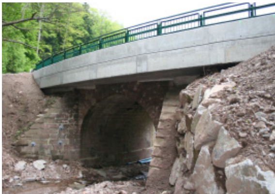
Élargissement d'une voûte en maçonnerie par une dalle en béton armé posée
