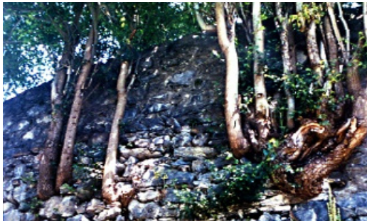
Végétation désorganisant la maçonnerie
