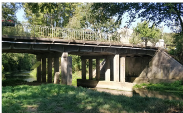
Années 1930 – ouvrages fins, peu de ferrailage dans les zones tendues
