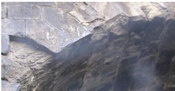
Altération généralisée de bandeau
