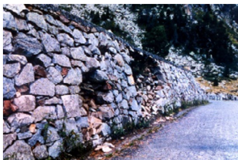
Effondrement partiel d'un mur en maçonnerie
