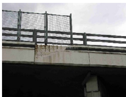
Impact sur corniches
