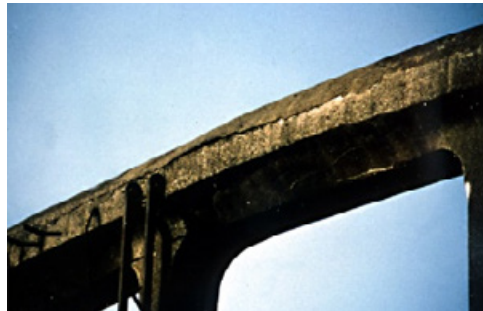
Décollement d'un enduit
