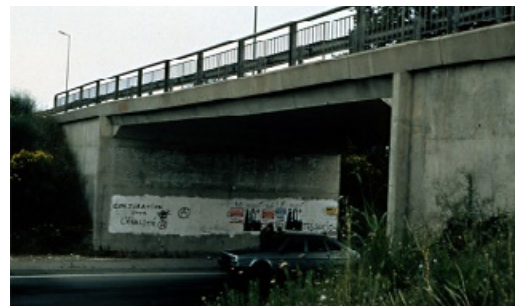
Flèche liée à un excès de charge ou un défaut de résistance
