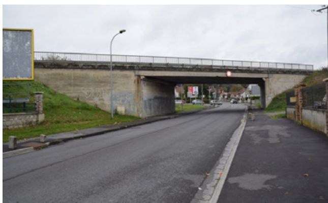
Toutes les parties de l'ouvrage (structure et équipements) sont accessibles et visibles.
