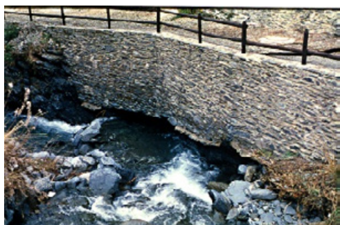
Affouillement avec altération de la fondation
