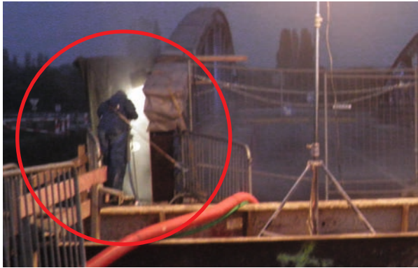
Figure 266 : Hydrodémolition manuelle d'une partie peu accessible entre le pont actuel et les canalisations de gaz
