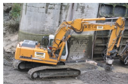
Figure 126 : Fraiseuse servant à démolir en général les parties altérées des maçonneries d'écluse
