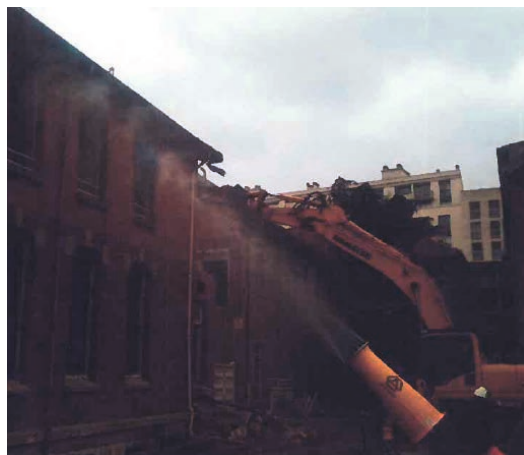
Figure 105 : Brumisateurs dirigés vers la source de poussières (photo Ent. DSD, SMD)
