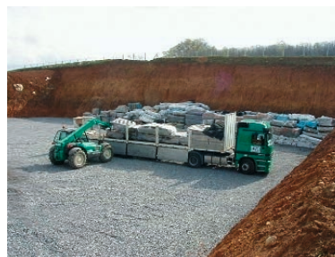
Figure 92 : Recouvrement - Alvéole pour amiante lié, ISDND de Saint Laurent - site internet du syndicat intercommunal des déchets de la Dordogne
