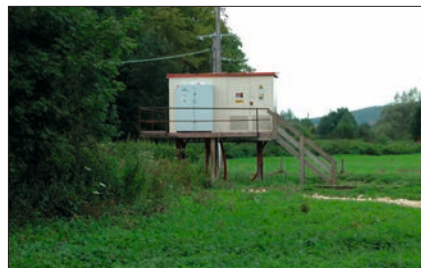
Figure 294 : Poste électrique provisoire de chantier situé en zone inondable, et positionné au-dessus du niveau de crue
