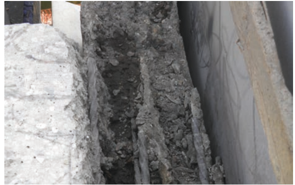
Figure 267 : La surface est fortement décapée car le but n'était pas de récupérer le béton mais de démolir une zone difficilement accessible par d'autres méthodes. NB : Les parois attenantes et la canalisation doivent être protégées des éclats
