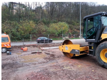
Figure 103 : Réalisation de planches d'essai d'un compacteur évoluant à proximité de conduites de transport de gaz
