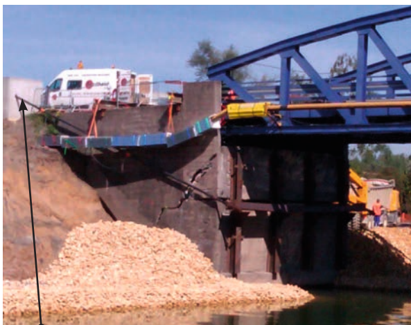
Figure 264 : NB : Système de retenue du mur de front. (vue partielle). Les câbles sont ancrés au-delà des déviateurs ruinés
