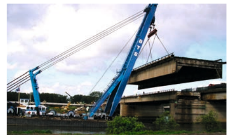
Figure 107b : Bigue fluviale de capacité 300 t - Chargement d'une traverse de 53 m d'un pont métallique
