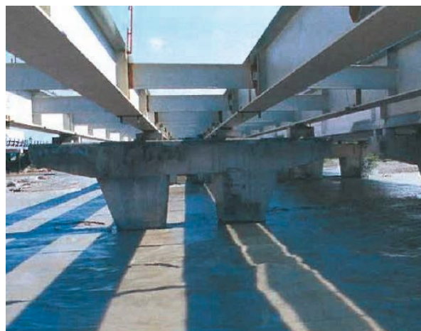
Figure 202 : Le tablier est entièrement détruit, et évacué. Les piles peuvent être réutilisées
