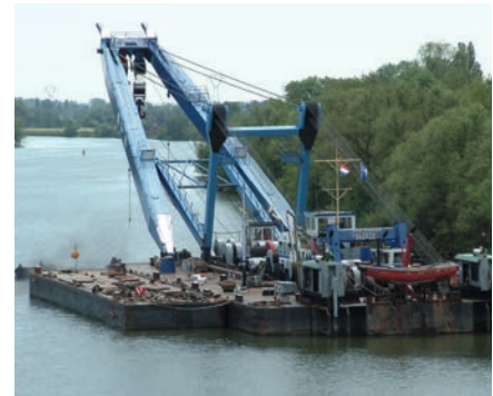
Figure 107a : Bigue fluviale de capacité 300 t - Arrivée pliée, ici, phase de montage
