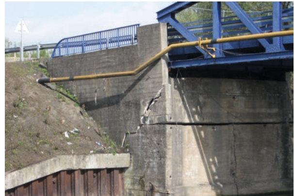
Figure 263 : Vue de la culée fracturée et ruinée
