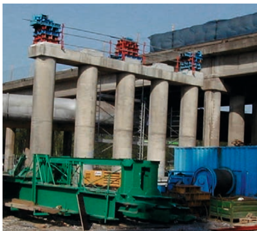
Figure 74 : Pile type du pont d'accès. Photo du réaménagement de tête. Nota : les camarteaux sont en attente de l'ossature 5 poutres (qui pour le lancement ne s'appuie que sur 3 poutres).
