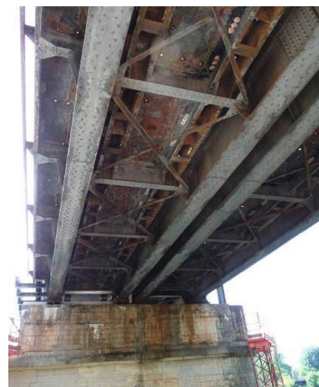
Figure 182 : Vue de l'état de l'intrados du tablier
