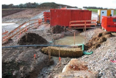
Figure 285 : Assainissement provisoire (sous-dimensionné ici) par bottes de paille (qui doivent être décompactés)
