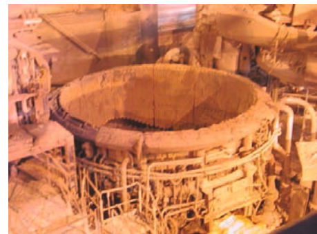
Figure 100 : Vue d'un four électrique
