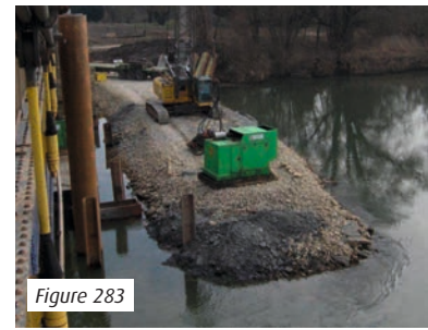
Figure 283 : Lors d'une inondation : le matériel est en cours d'évacuation, le remblai calé pour être submersible
