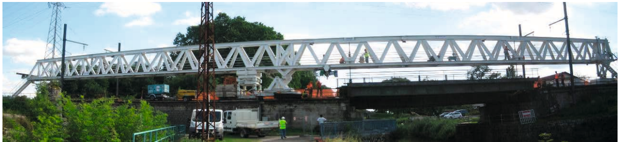
Figure 183 : Vue longitudinale du lanceur (de gauche à droite : la palée arrière amovible proche de la palée centrale, le pont roulant, le tablier en cours de levage et la palée avant escamotable)
