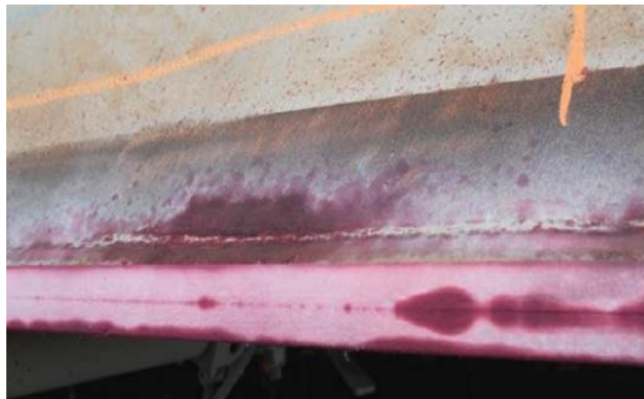
Figure 59 : Délamination de la tôle de la semelle inférieure
