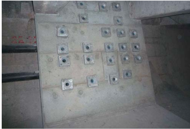
Figure 25 : Ancrage de deux câbles additionnels sur un massif près de la culée
