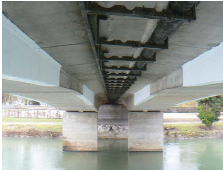
Figure 14 : Ouvrage réparé vis-à-vis de l'effort tranchant
