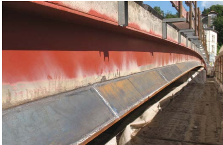
Figure 58 : Exemple de renforcement par une tôle inclinée - Cette disposition est également utilisée pour des ouvrages neufs
