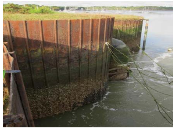
b) Corrosion d'un rideau de palplanches métalliques
