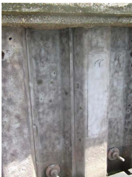
a) État du rideau après décapage et pose des tôles de renfort
