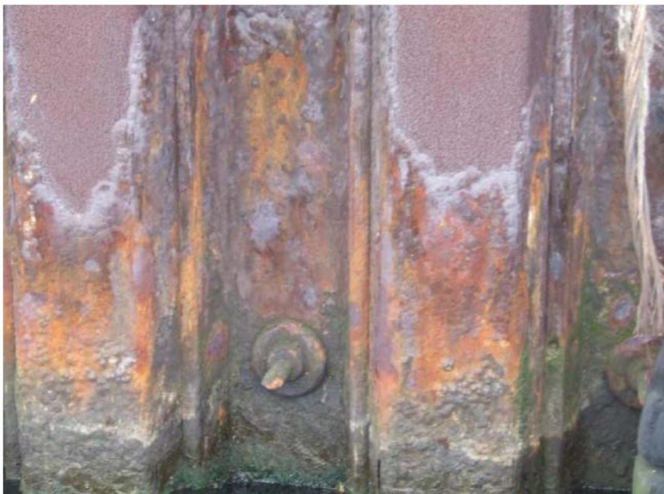
Figure IV.1.2 - Aspect du rideau avant travaux - quai de l'Escaut du port de Dunkerque
