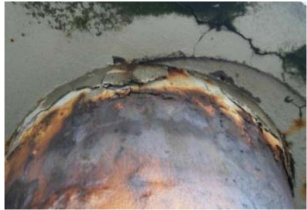
b) Zone d'éclaboussures associée lié aux produits de corrosion dans la zone de jonction métal-béton
