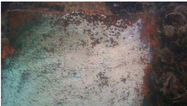
a) Corrosion généralisée affectant une palplanche plate
