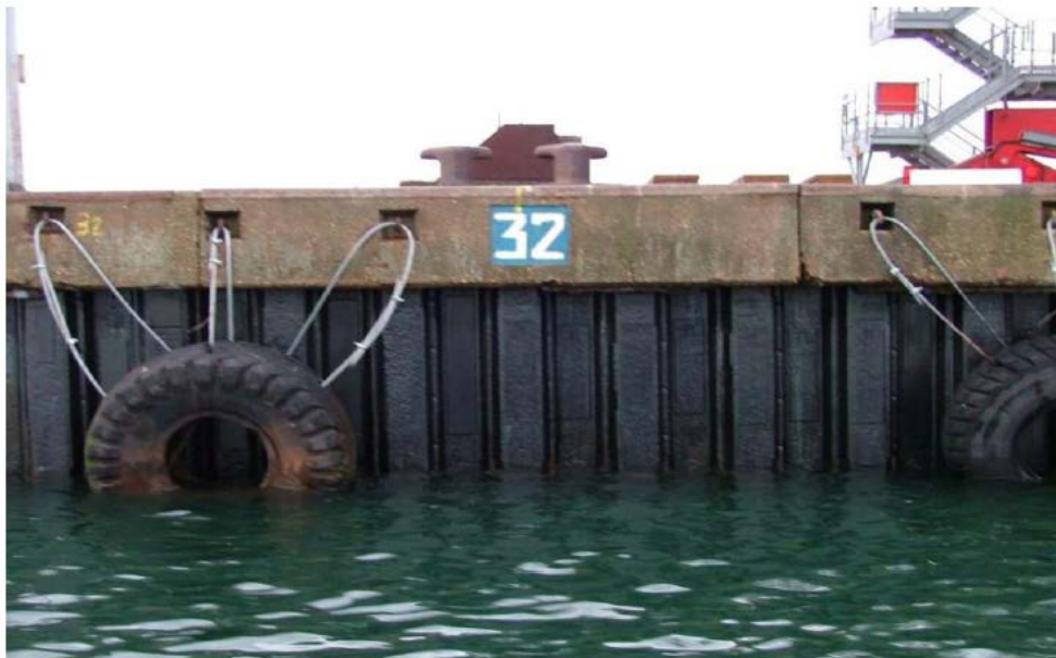
Figure IV.1.5 - Vue du rideau de palplanches après travaux - quai de l'Escaut du port de Dunkerque
