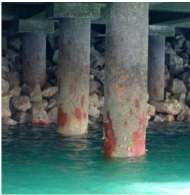
Faciès externe de pieux corrodés
