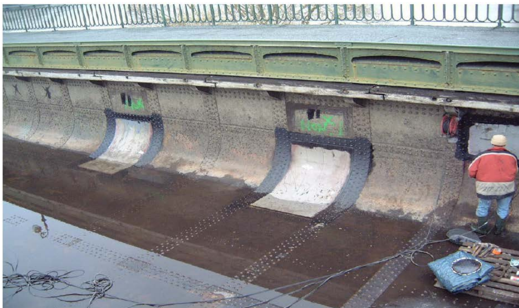
Figure IV.4.3 - Renforcement de la cuve du pont-canal de Briare par des panneaux inox - crédit CETE Normandie-Centre
