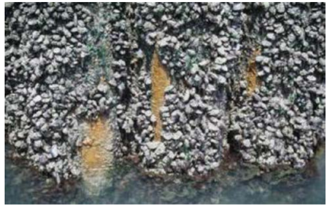
Faciès externe de palplanches corrodées
