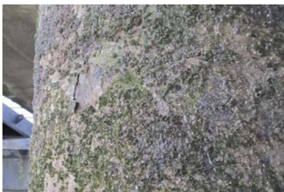
Dépôt de corrosion formé à la côte + 4m CM sur un pieu métallique en estuaire
