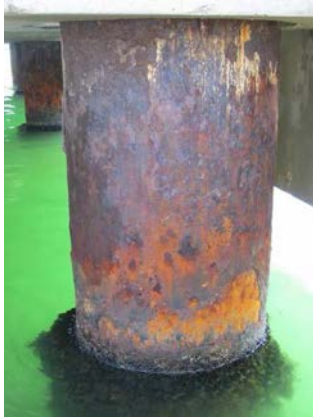
a) Corrosion d'un pieu métallique
