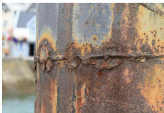
Dépôt de corrosion formé à la côte + 4m CM sur un pieu métallique en Atlantique
