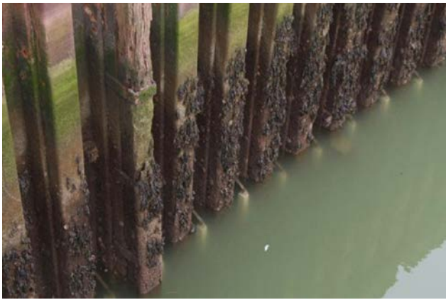
a) Corrosion d'un pieu métallique
