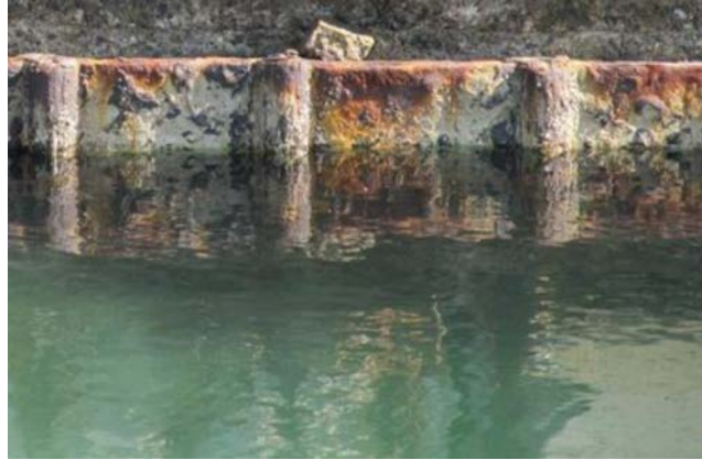
b) Corrosion d'un rideau de palplanches métalliques
