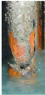
Rupture d'un pieu corrodé
