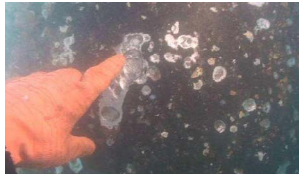
b) Corrosion localisée d'un pieu
