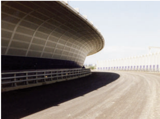
Photo 3 : écran absorbant sur ouvrage, avec casquette, composé de caissons et de poteaux métalliques (A86, Drancy)
