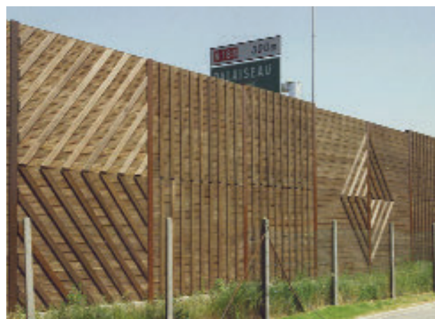
Photo 8 : écran réfléchissant composé de poteaux métalliques et de panneaux en bois exotique avec éléments décoratifs (A10, Palaiseau)
