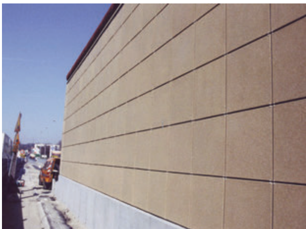
Photo 13 : écran absorbant composé de poteaux métalliques et de panneaux en béton revêtu d'un mélange de résine et de billes de verre (A86, Fresnes)
