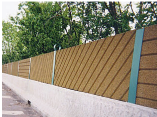
Photo 12 : écran absorbant fixé sur un muret en béton et composé de poteaux métalliques et de panneaux en béton de bois
