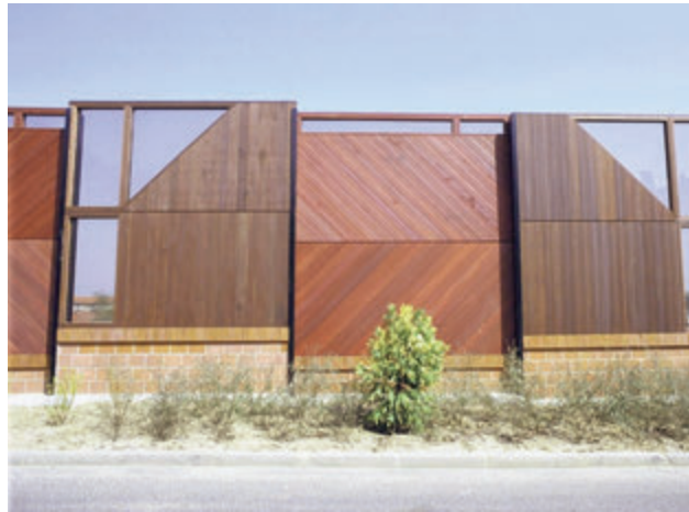
Photo 10 : écran réfléchissant composé de poteaux métalliques, de panneaux en bois exotique avec inclusions plastiques et d'un soubassement en briques acoustiques (A86, Rosny-sous-Bois)
