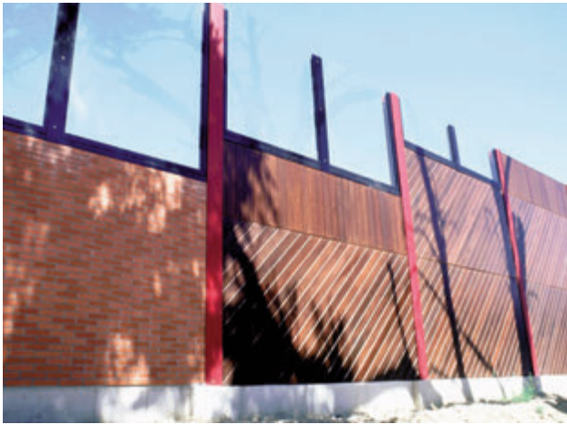
Photo 9 : écran réfléchissant composé de poteaux métalliques, de panneaux bas en bois exotique ou en briques et de panneaux hauts en plastique (Liaison A104/RN2)
