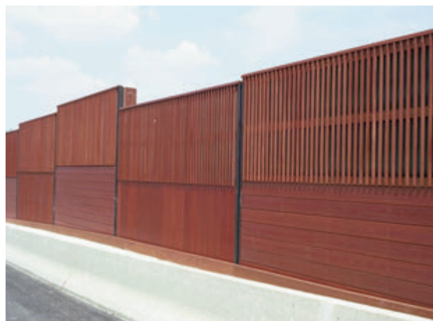
Photo 6 : écran absorbant/réfléchissant composé de poteaux métalliques et de panneaux en bois exotique (A86, Rosny-sous-Bois)
