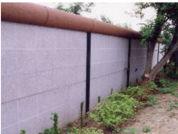
Photo 11 : écran absorbant composé de poteaux métalliques, de panneaux en béton de bois et d'un couronnement absorbant (RN 184, Éragny)
