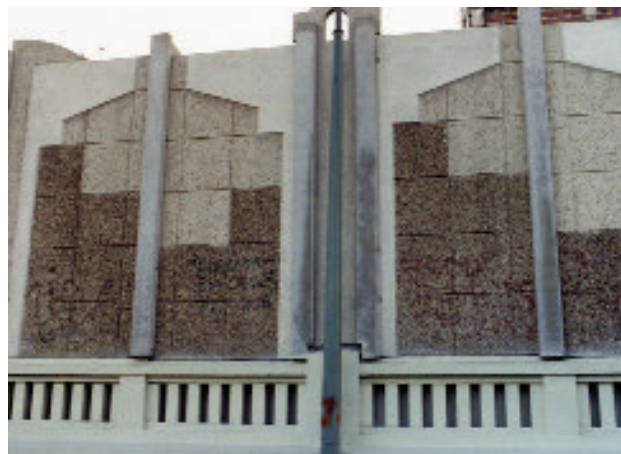
Photo 14 : écran réfléchissant composé de poteaux et de panneaux préfabriqués en béton (boulevard périphérique de Paris, porte de Châtillon)
