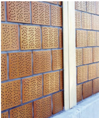
Photo 17 : écran absorbant composé de poteaux métalliques et de panneaux en briques acoustiques (A3, Bobigny)
