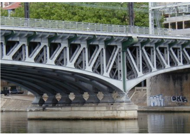
Photo 9 – Les rotules d'une des piles en rivièrre du pont ferroviaire Kitchener à Lyon
