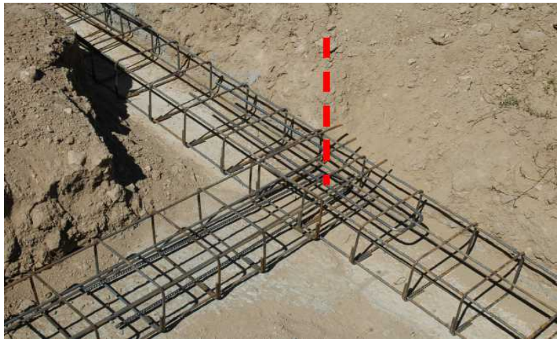
Absence de chaînage vertical
