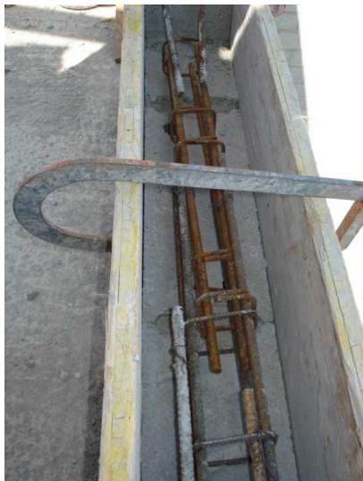
Continuité mécanique insuffisante
