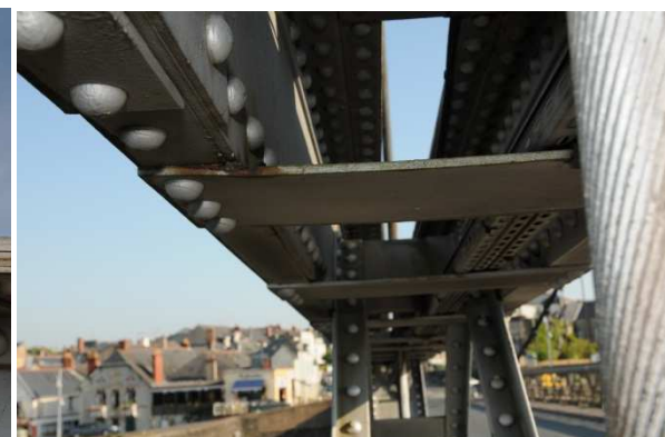
Déformation des barrettes de liaison
