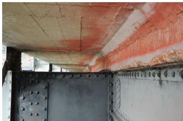
Connexion dalle longeron détériorée
