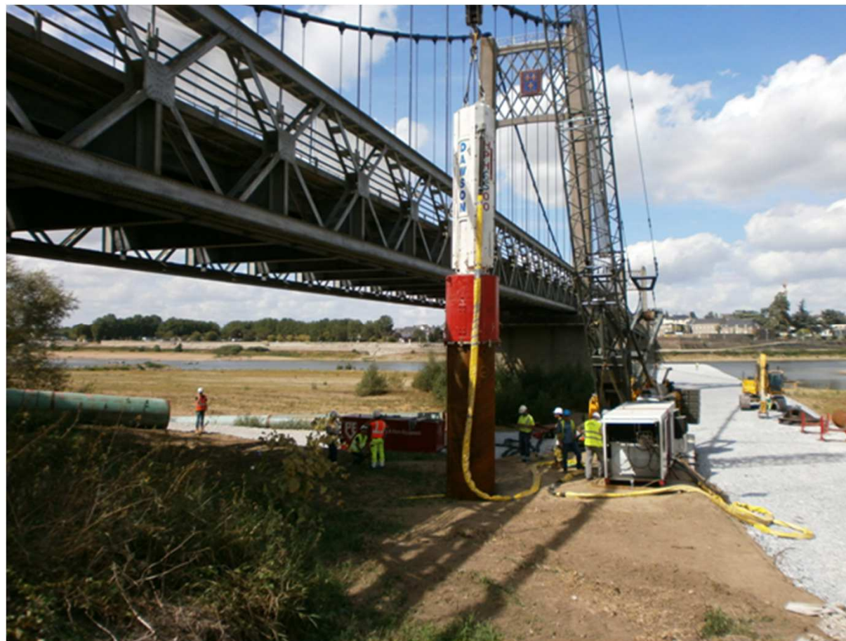
Battage d'un tube en terrestre Grue flèche treillis 110 tonnes Marteau DAWSON HPH6500 et groupe hydraulique associé
