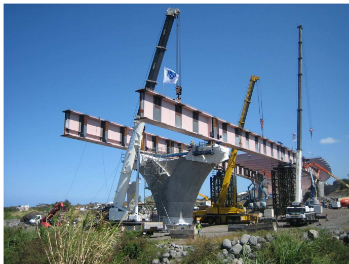
Photo 7.3-11 : (2012) Viaduc de la rivière Saint-Etienne (île de la Réunion) : 4546t dont 1400t S460M(L) ep. max. 120mm (Photo Baudin-Chateauneuf - S. Pauvert)
