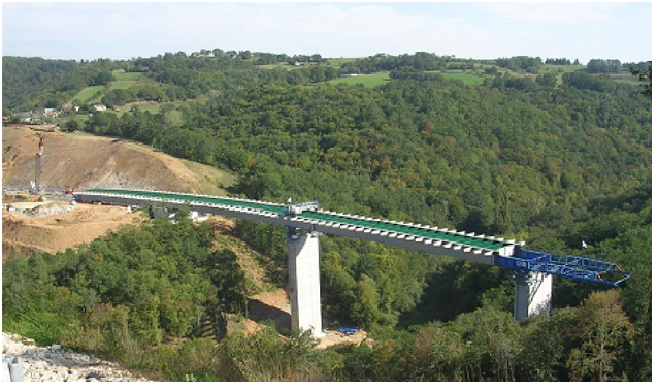
Photo 7.3-6 : 2008 : Viaduc du Ribeyrol (A89 ouest) : 1500t dont 215t S460M(L). ep. max.100mm (Photo Baudin-Chateauneuf - S. Pauvert)
