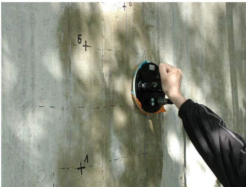
photo 2.4 : Mesure de vitesse de corrosion
