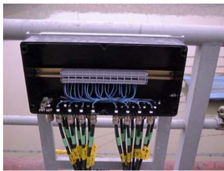
photo 4.11 : Armoire de connexions
