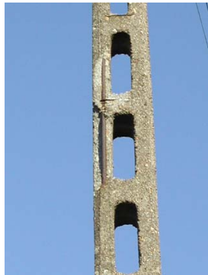
photo 1.4 : Poteau support de ligne électrifiée
