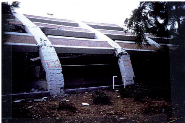
Figure 7 : Exemple de rupture en flexion de poteau
