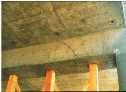
(a) : Rupture par cisaillement d'une poutre lors du séisme de Northridge 1994 [28]
