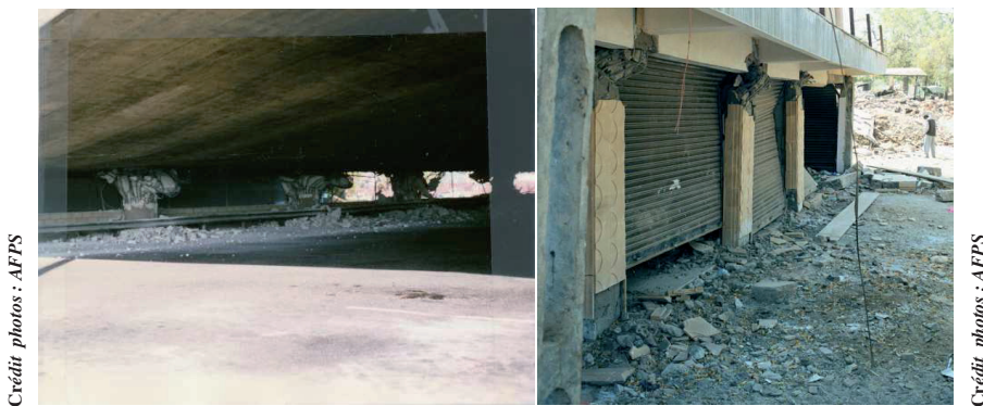
(a) : Rupture par plastification de la zone critique lors du séisme de Northridge 1994
