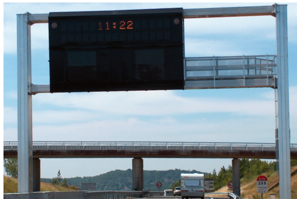
Photo 2 : Portique double traverse (porteur d'un caisson PMV)
