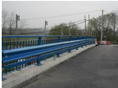
Garde corps + glissière
