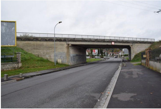
Toutes les parties de l'ouvrage (structure et équipements) sont accessibles et visibles
