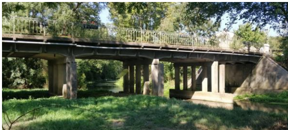
Années 1930 – ouvrages fins, peu de ferrailage dans les zones tendues
