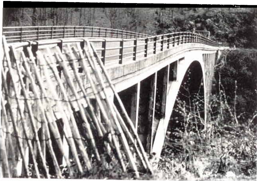
Fig. 4. --- Conséquences d'un mouvement de terrain : les culées de l'arc ont été entraînées et se sont rapprochées.
