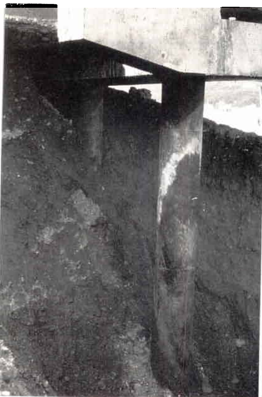
Fig. 5. — Mise à nu de la fondation d'une culée par érosion du remblai.
