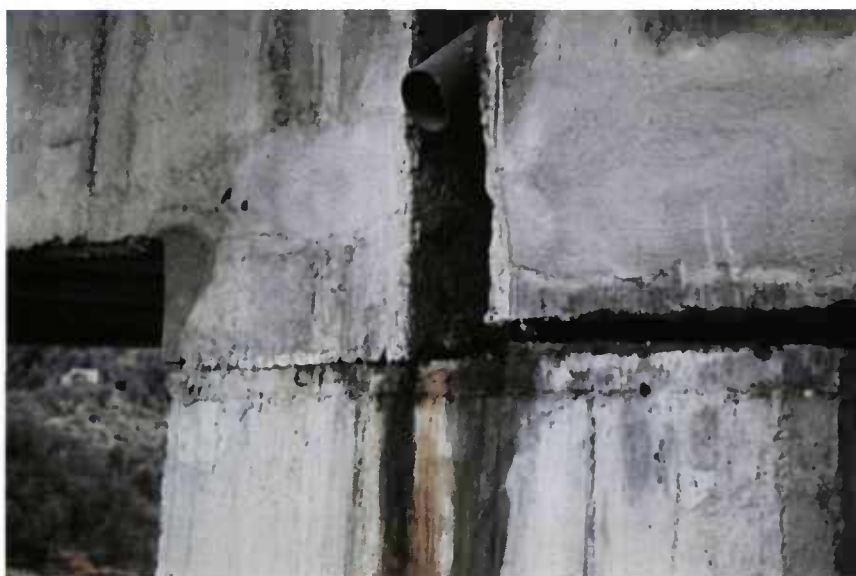
Fig. 3.07 - Évacuation d'eau mal conçue.
