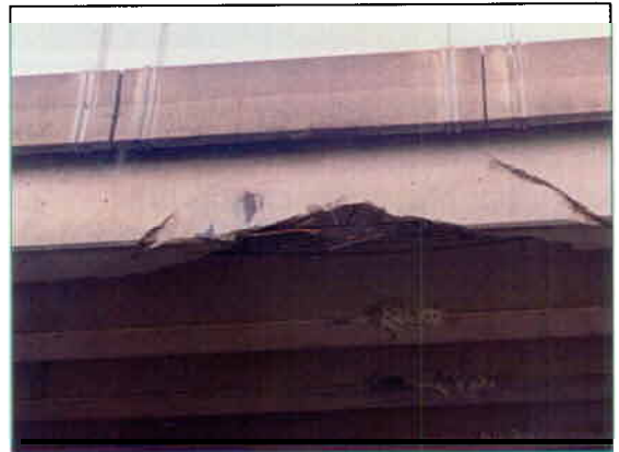
Fig. 21 - Les chocs dans les poutres peuvent provoquer des dégâts importants, la poutre de rive est à remplacer.
