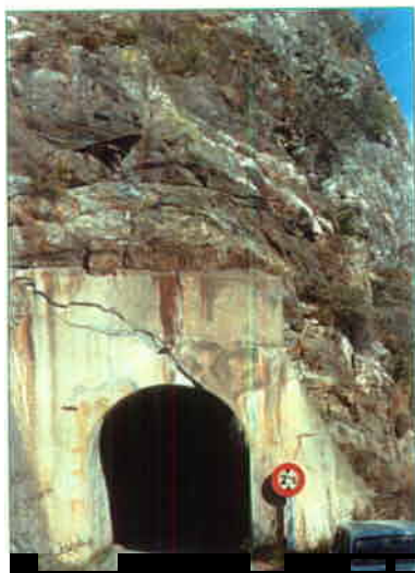
Fig. 13 - Désordres en tête de tunnel ancien.
