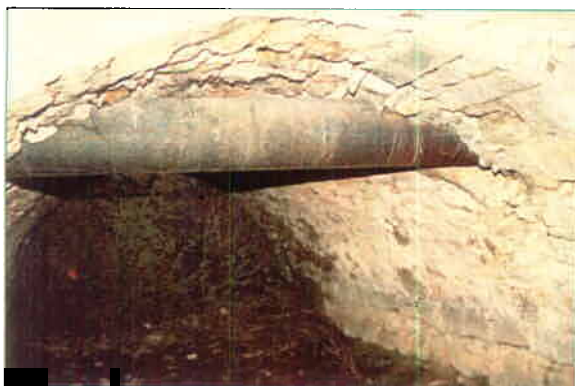
Fig. 27 - Traversée sauvage de voûte par une canalisation d'eau potable.
