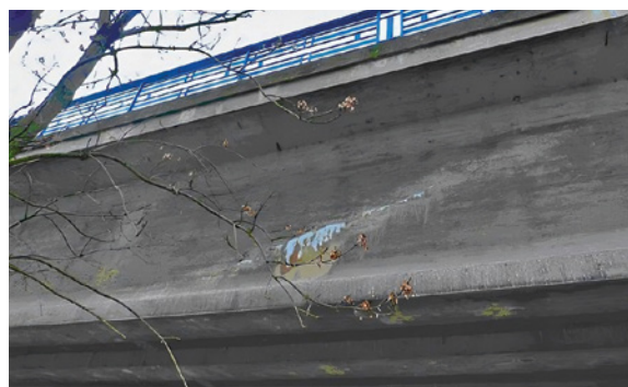
Photo 63 : Fissures remontantes le long de câbles
