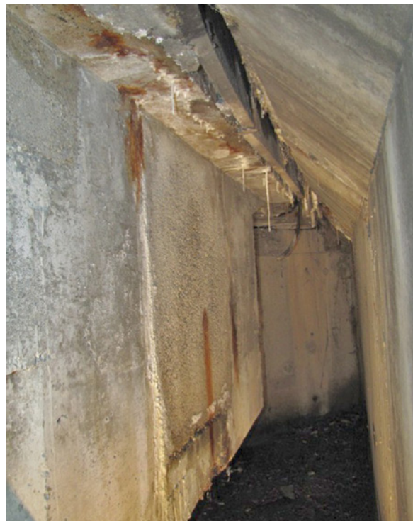
Photo 60 : Écoulement le long des abouts du fait d'un assainissement déficient
