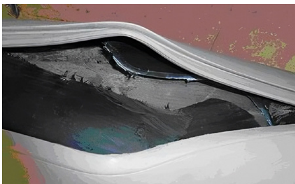
Photo 47 : Fissure longitudinale sur une gaine en PEHD réparée par chemisage
