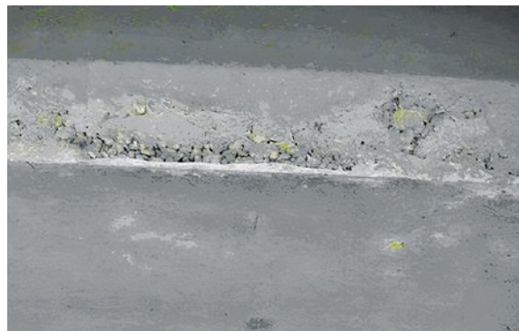
Photo 57 : Nids de cailloux dans le talon d'une poutre
