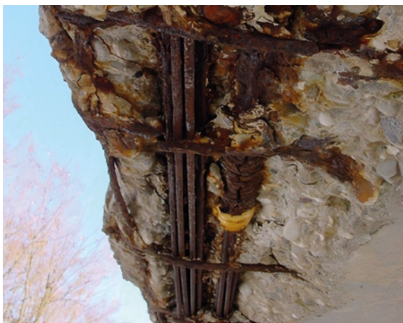
Photo 22 : Conduits non injectés et câbles corrodés
