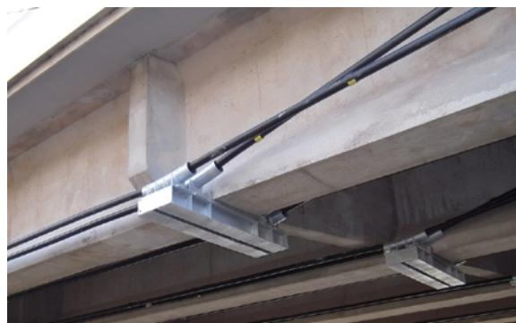
Photo 12 : Précontrainte extérieure longitudinale à l'extérieur de la structure
