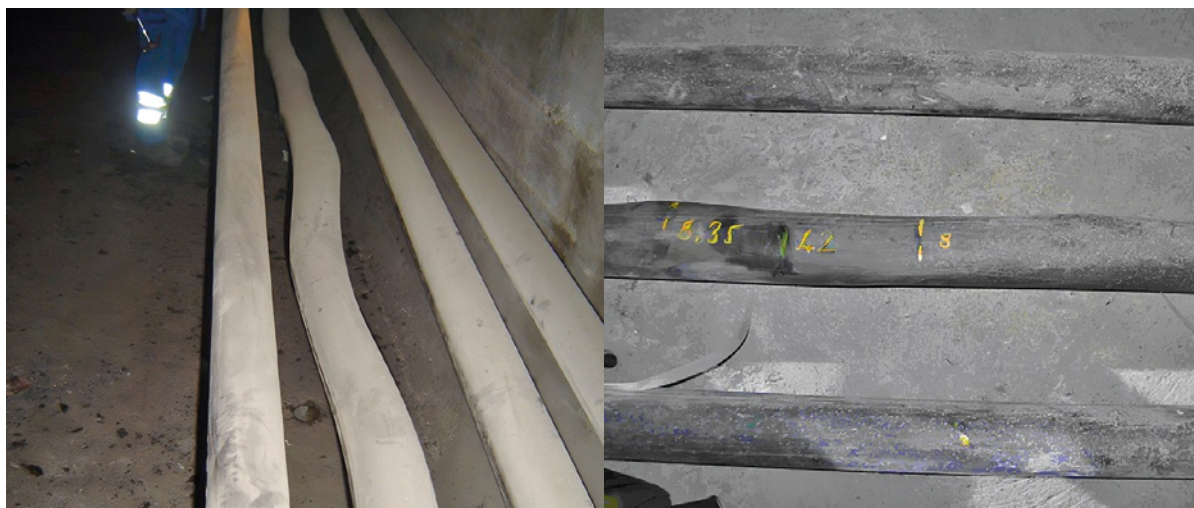
Photos 55 et 56 : Précontrainte extérieure Déformation d'une gaine PEHD due à des ruptures de fils d'un ou plusieurs torons
