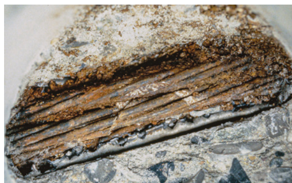
Photo 72 : Fils coupés lors d'un carottage non maîtrisé pour l'ouverture d'une fenêtre
