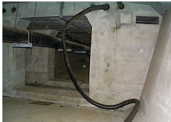
Photo 75 : Rupture d'un câble
