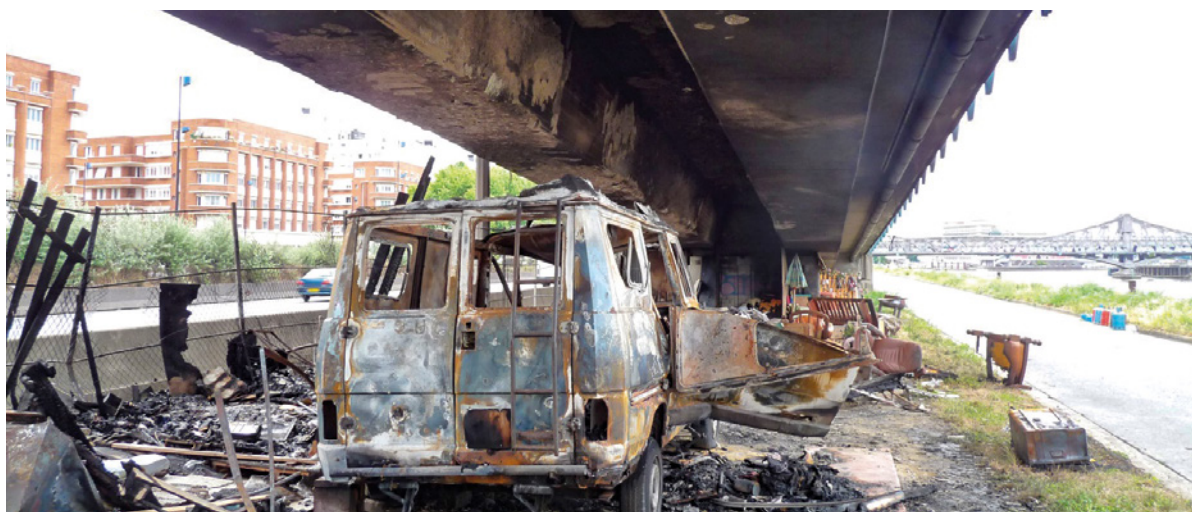
Photo 70 : Importante dégradation d'un ouvrage en béton précontraint après un incendie
