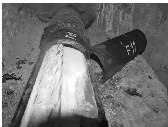
Photo 61 : Défaut d'injection à proximité d'un ancrage
