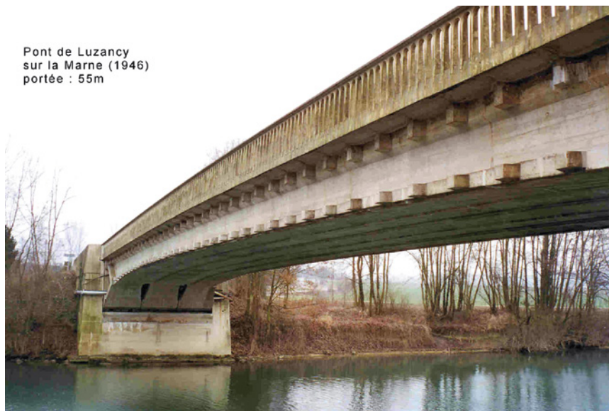
Photo 1 : Pont de Luzancy sur la Marne – Premier grand pont en béton précontraint (1946) Conception Eugène Freyssinet
