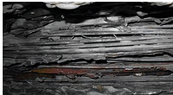
Photo 43 : Gaine oxydée et câbles présentant une oxydation
