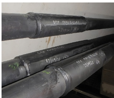
Photo 83 : Fermeture définitive par manchons ajustés et soudés par extrusion sur la gaine après application de cire au pinceau
