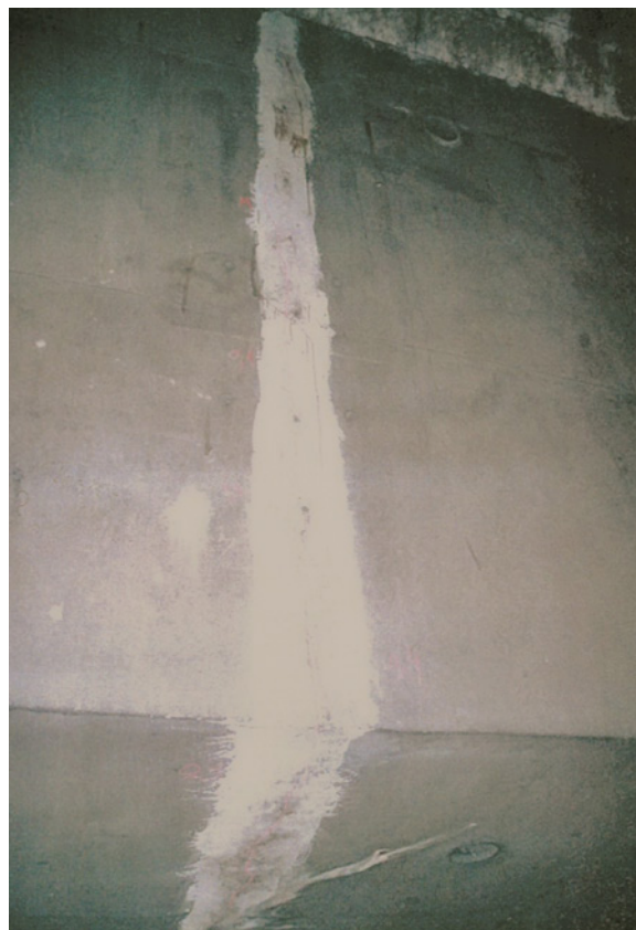
Photo 67 : Exemple d'une réparation infructueuse : injection de joint sans précontrainte additionnelle et réapparition de la fissuration du joint l'été suivant sous les effets cumulés du gradient et des charges d'exploitation
