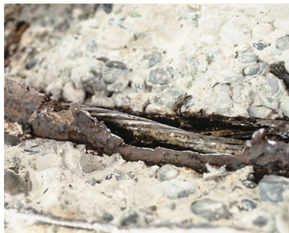
Photo 23 : Conduit non injecté et câble graissé
