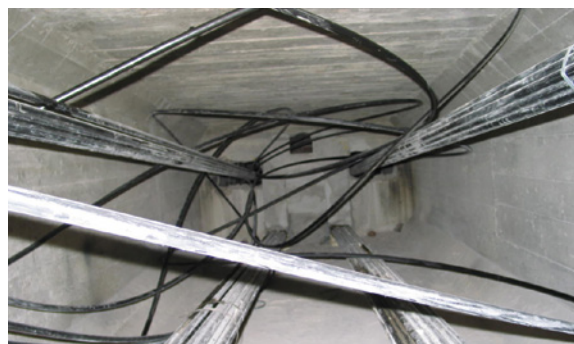
Photo 52 : ... puis rupture de câbles par corrosion fissurante
