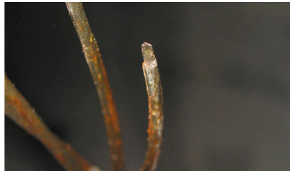
Photo 42 : Rupture d'un fil amorcée par une corrosion fissurante (photo SPW)
