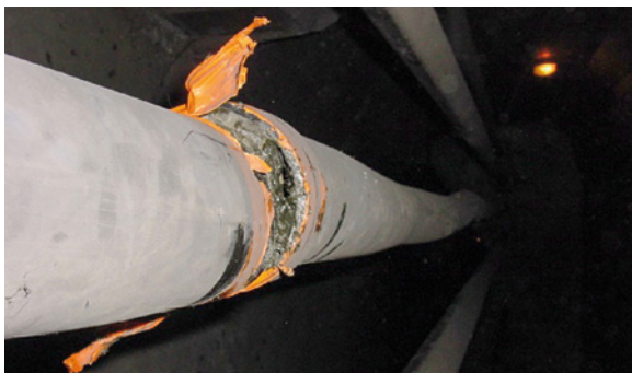
Photo 49 : Déboîtement de conduit en PEHD, injecté à la graisse
