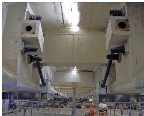
Photo 110 : Précontrainte additionnelle sur un VIPP avec bossages précontraints sur la structure (pont du Château-Rouge, MEL)
