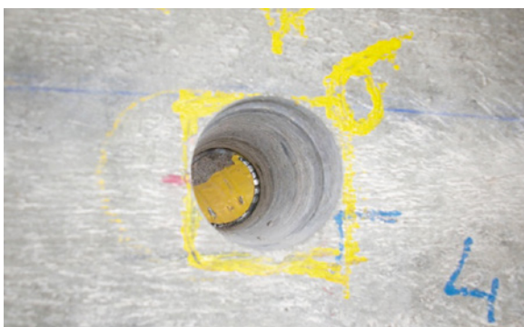
Photo 71 : Carottage interrompu au niveau d'un câble
