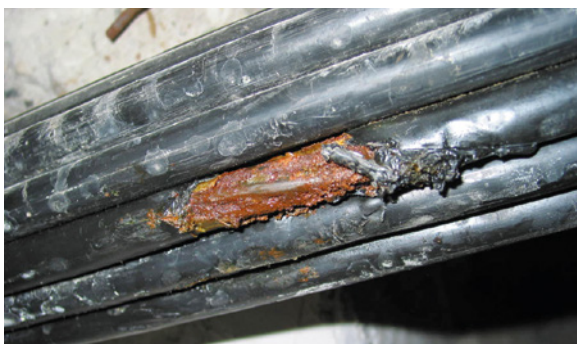
Photo 51 : Défauts des gaines (et au niveau des ancrages) puis de la protection par la graisse...
