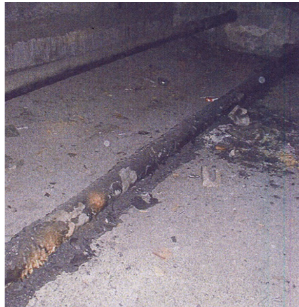
Photo 18 : Gaine d'un câble de précontrainte extérieure dans un caisson entièrement fondu suite à un incendie lié à une occupation de l'ouvrage
