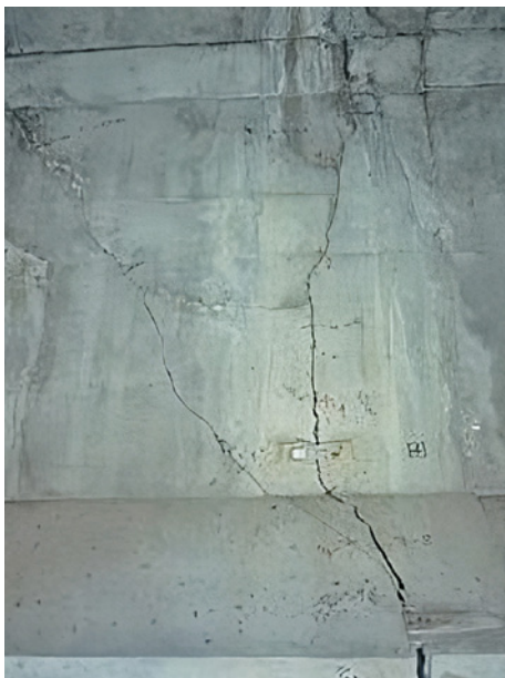
Photo 64 : Poutre de VIPP fissurée sur toute sa hauteur
