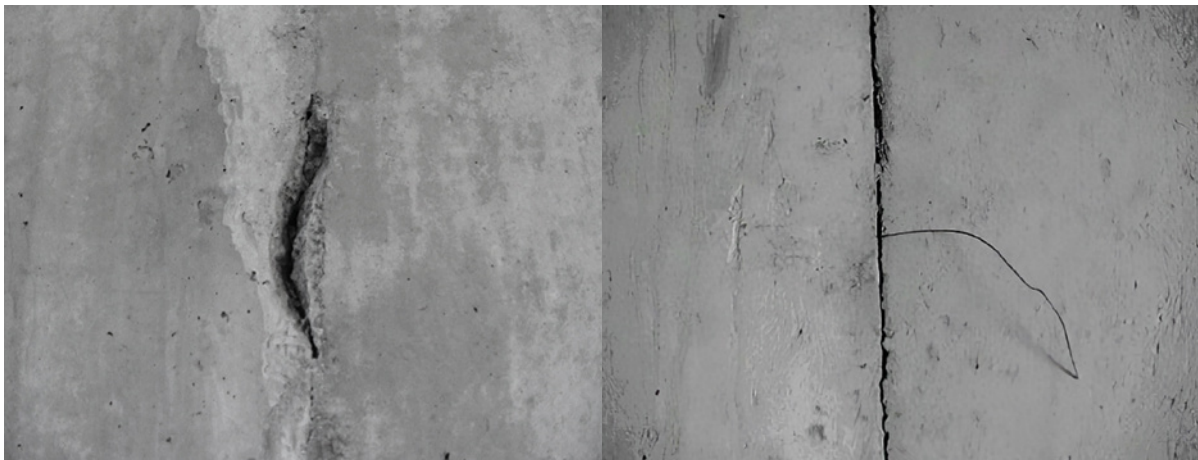
Photos 58 et 59 : Défauts de réalisation ou de conjugaison de joints
