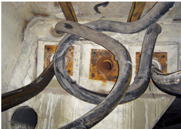
Photo 74 : Déformation d'un câble lors d'un démontage
