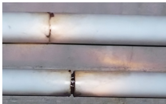
Photo 48 : Rupture des soudures des gaines extérieures en PEHD
