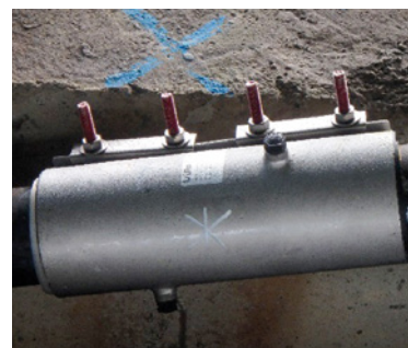
Photo 84 : Fermeture définitive par collier en acier inoxydable (avec injection de cire pétrolière)
