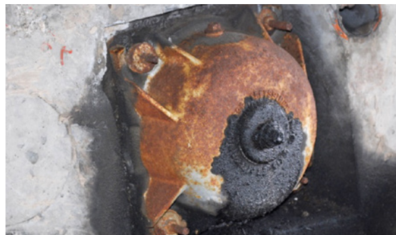
Photo 50 : Capot de protection d'ancrage injecté à la graisse, présentant des fuites
