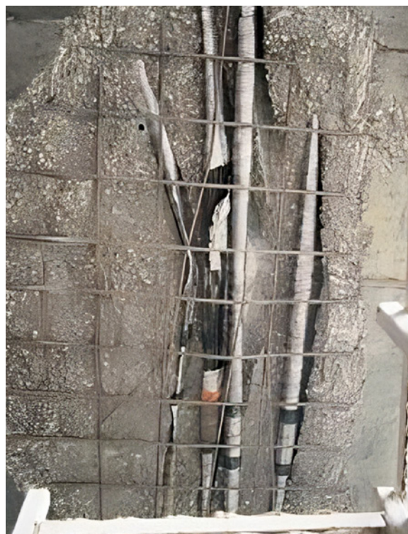
Photo 54 : Éclat de béton important en hourdis inférieur d'un pont de type poutre-caisson à voussoirs coulés en place, dû à la poussée au vide lors de la mise en tension des câbles (erreur de positionnement des conduits au droit d'un joint de voussoirs)
