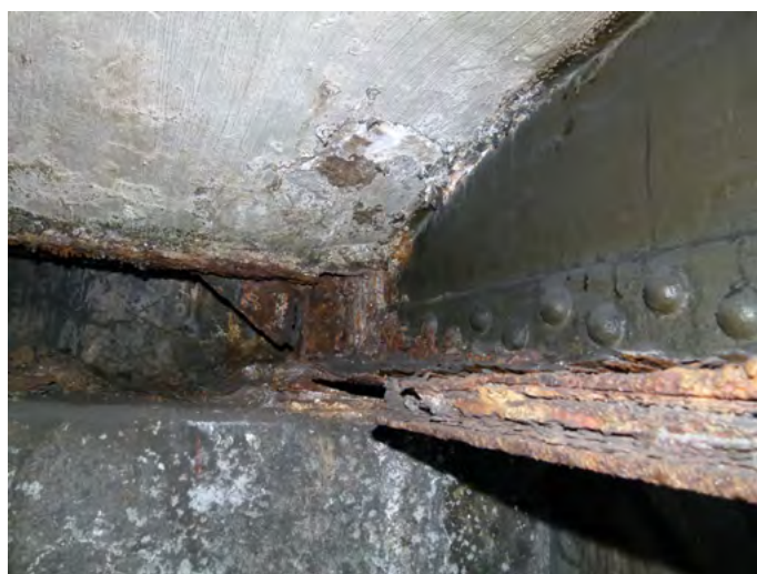
Illustration 159 : Dégradation d'une poutre de couverture
