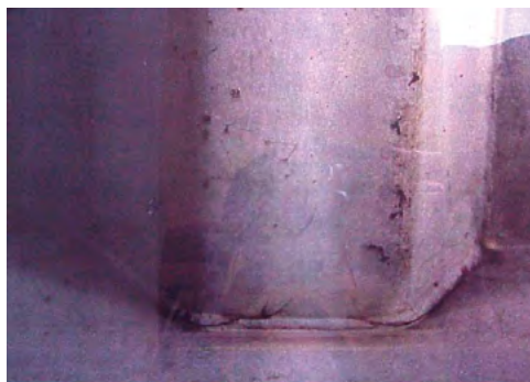
Illustration 102 : Exemple d'une fissuration de fatigue au niveau de la liaison auget-pièce de pont
