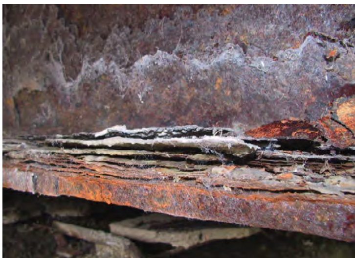
Illustration 88 : Exemple de corrosion feuilletante d'une poutre en fer puddlé
