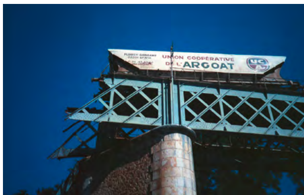
Illustration 105 : Rupture fragile d'un ouvrage en fer puddlé : crédit ©SNCF
