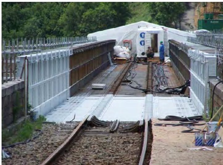
Illustration 128 : Protection liée à la remise en peinture
