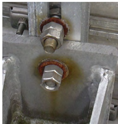
Illustration 89 : Exemple de corrosion galvanique entre écrous en inox et rondelles en acier galvanisé
