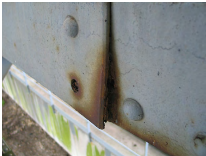
Illustration 23 : Corrosion à l'interface d'un assemblage
