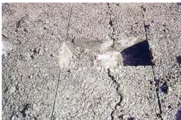
Illustration 119 : Fissuration du complexe étanchéité-roulement (Cer) jusqu'à la membrane d'étanchéité (crédit photo Cerema, BOA 54, F. Imberty)
