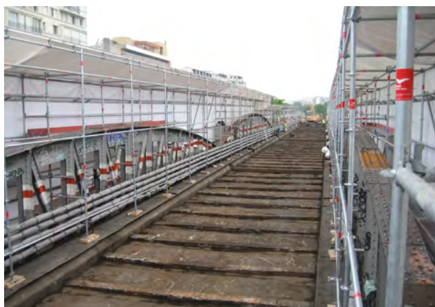
Illustration 132 : Mise à nu d'un tablier
