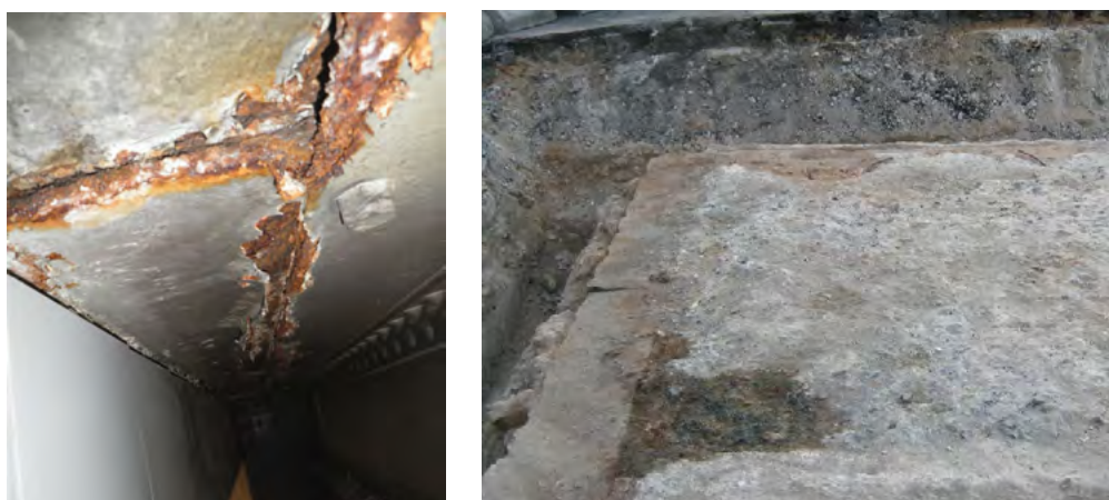
Illustration 165 : Dégradations vues depuis le souterrain, puis depuis la chaussée
