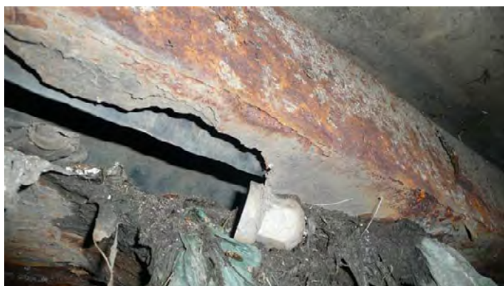
Illustration 124 : Gouttière de récupération d'un joint de chaussée très dégradée
