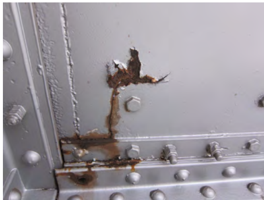
Illustration 81 : Fissure de platelage sur ouvrage ferroviaire
