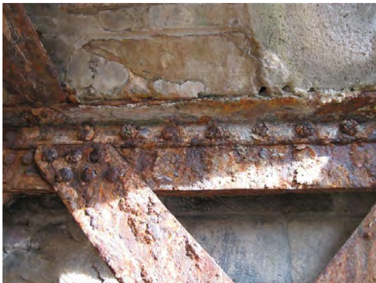
Illustration 134 : Corrosion d'un assemblage riveté
