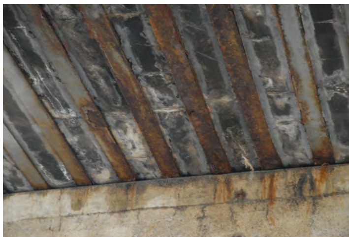
Illustration 70 : PPE avec un fonctionnement mixte acier/béton et des poutres corrodées
