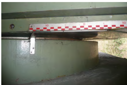
Illustration 123 : Mouvement anormal de l'appareil d'appui ou de la structure
