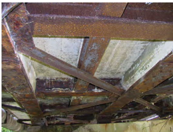
Illustration 86 : Exemple de corrosion uniforme sur ouvrage
