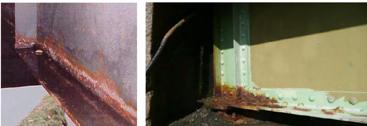
Illustration 95 : Exemples de dégradation par corrosion d'éléments métalliques
