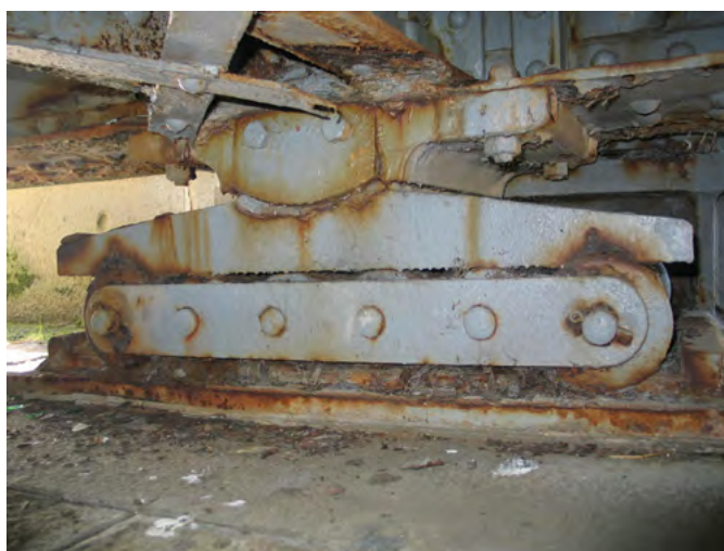
Illustration 137 : Appareil d'appui à rouleaux bloqué par la corrosion
