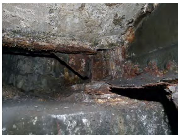
Illustration 163 : Corrosion d'une poutre de couverture
