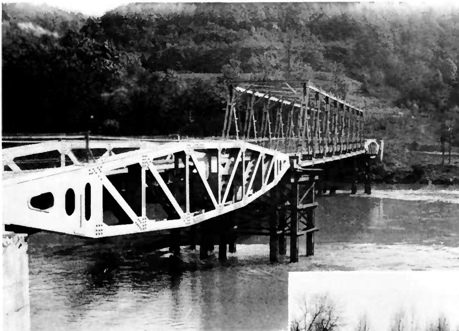
Fig. 2 - Pont provisoire à deux travées de types différents : l'une est constituée par des éléments Arromanches, au premier plan ; et l'autre, au second plan, par un pont en treillis métallique type Pigeaud.
