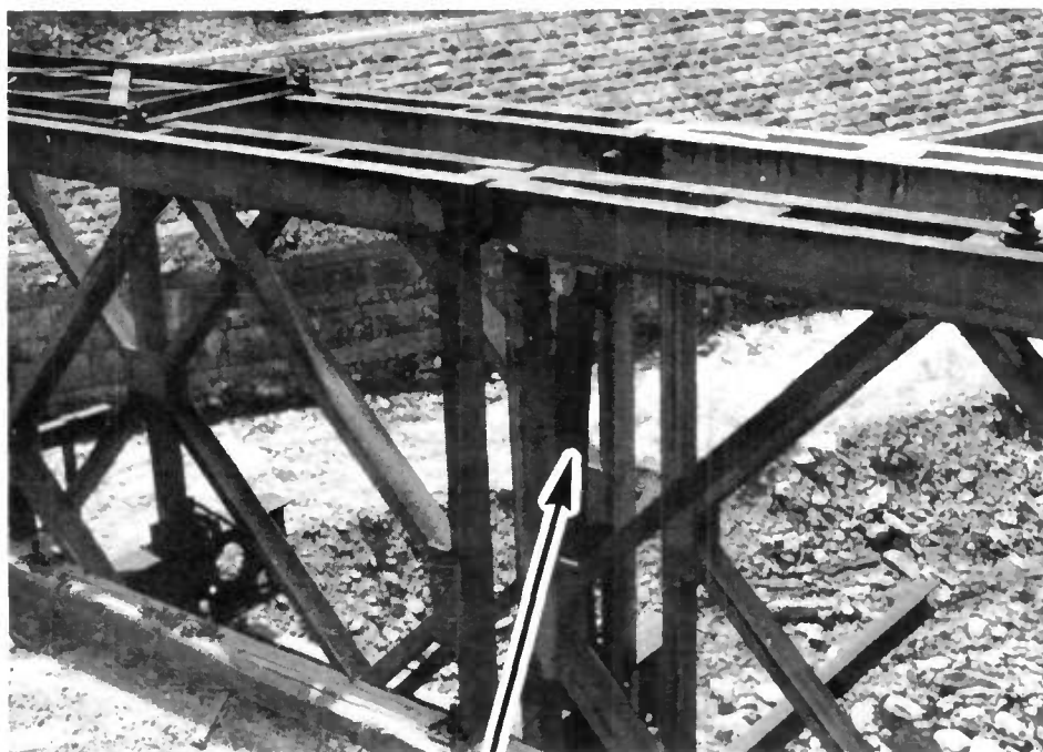
Fig. 9 Désolidarisation d'une jambe de force.
