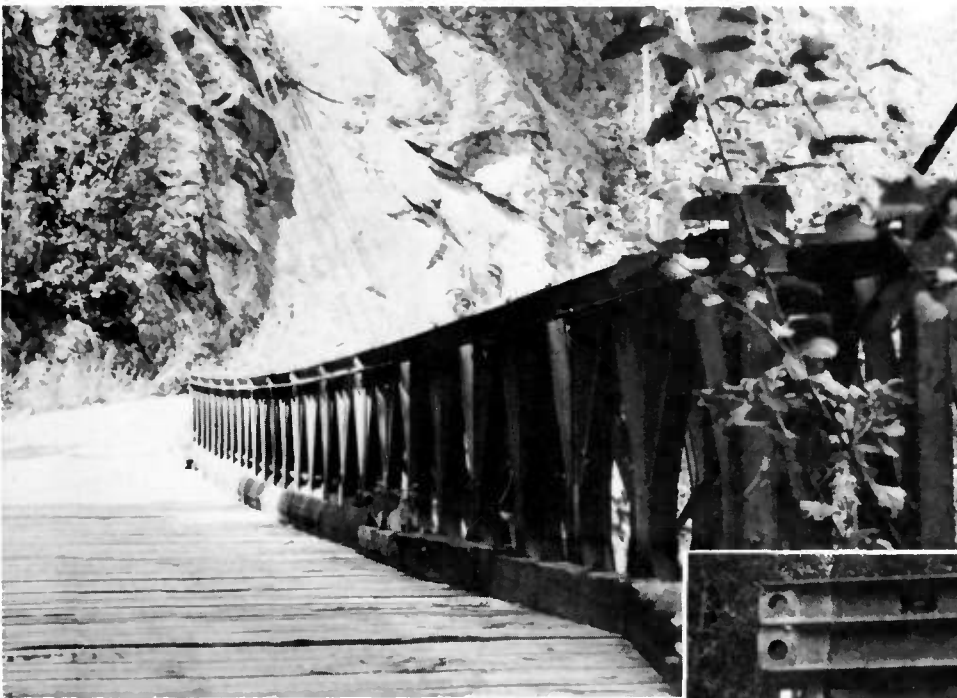
Fig. 7 - Structure insuffisante - Excès de flèche.
