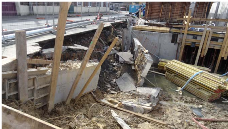
Figure 4 : Effondrement d'un ouvrage de soutènement
