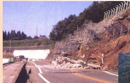
Chutes de blocs
