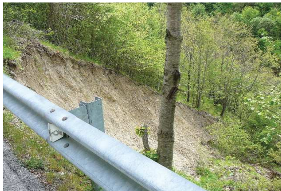
Glissement de terrain (SS80, 35 km de l'Aquila)
