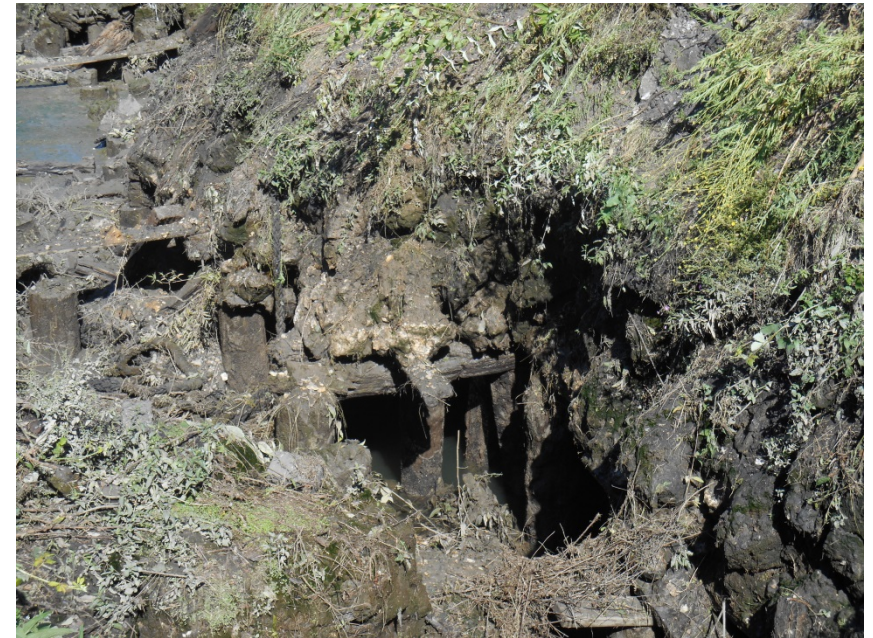
Platelage bois détruit
