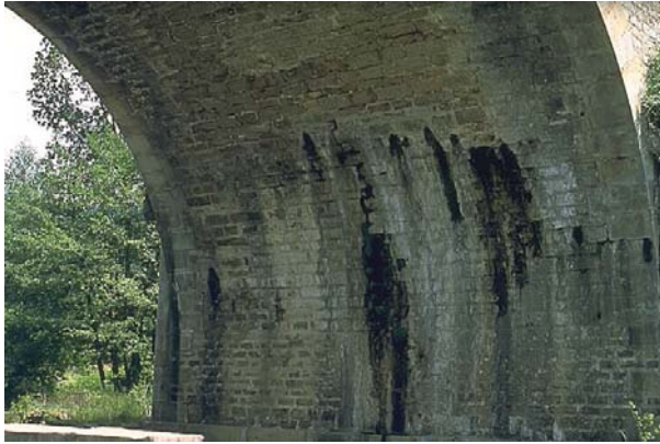
Défaut d'étanchéité d'un pont en maçonnerie
