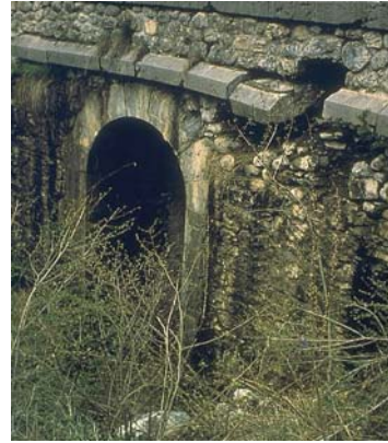
Délavage des joints par défaut d'écoulement de l'eau
