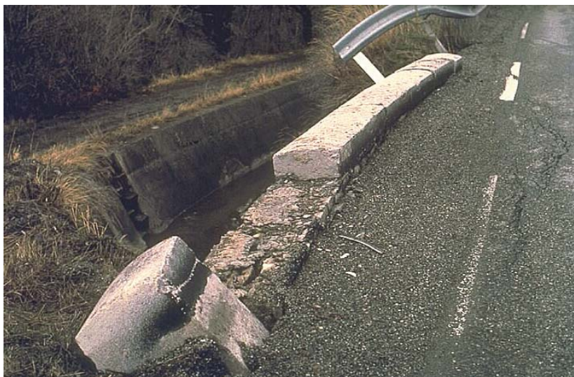
Effondrement du parapet d’un pont en maçonnerie
