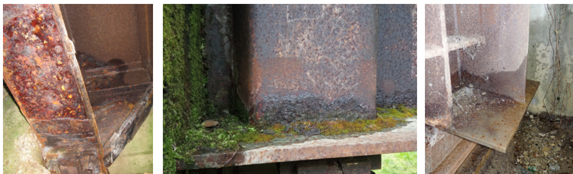
Figure 12 : Exemples de dégradations donnant lieu à une aggravation de la note de la patine (Source : UGE)
