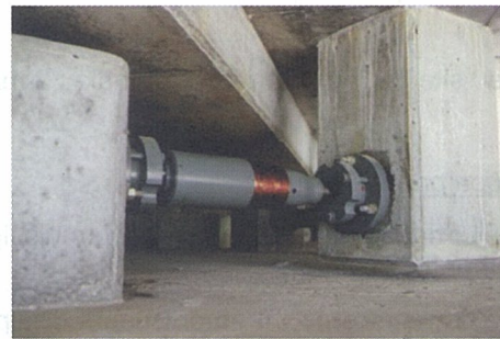
Photo 24 : Amortisseur biais disposé entre deux blocs d'appui
