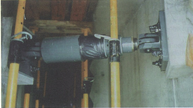
Photo 14 : Blocs d'appui des dispositifs parasismiques
