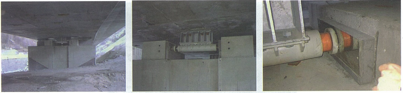
Photo 27 : Dispositifs amortisseurs précontraints disposés transversalement sur piles
