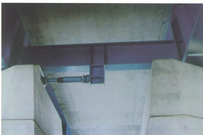
Photo 22: Amortisseur transversal sur pile
