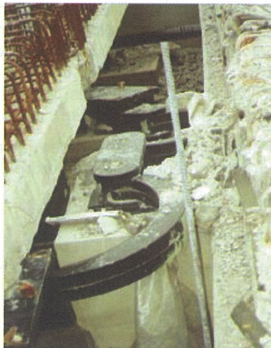
Photo 3 : Dispositifs élastoplastiques de type « croissants de lune » rompus après avoir subi un séisme deux fois supérieur au séisme de calcul mais ayant néanmoins évité l'effondrement de l'ouvrage sur lesquels ils étaient disposés (Bolu Viaduct) lors du séisme de Duzce (Turquie, 1999) [14]
