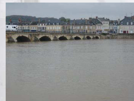
Ouvrage fluvial au débouché hydraulique sous dimensionné (photo: LR de Blois)
