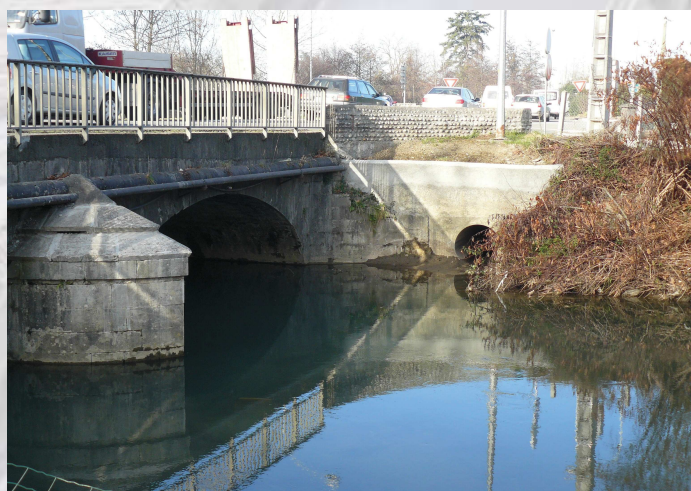
Ouvrage en maçonnerie sur « rivière de plaine » au débouché hydraulique mal dimensionné (photo: DIR Atlantique)
