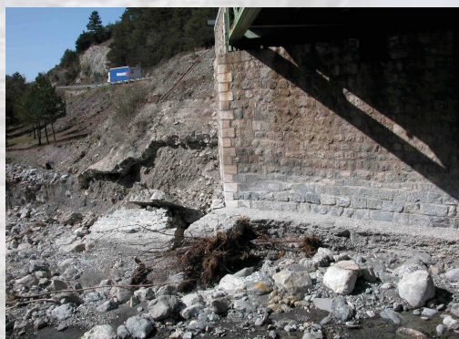
Affouillement d'une culée en saillie d'un pont (photo: Cerema Méditerranée)
