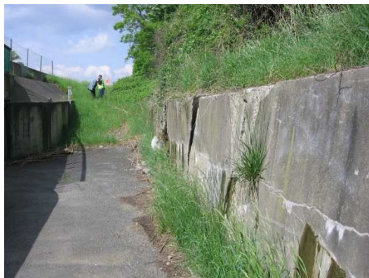
État du mur en juin 2010
