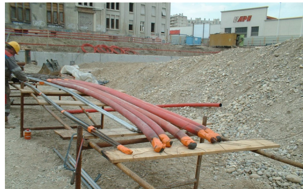
Photo 6.2 : Remarquer la gaine de la partie libre de ces tirants en cours d'assemblage sur site (© Sefi Intrafor)
