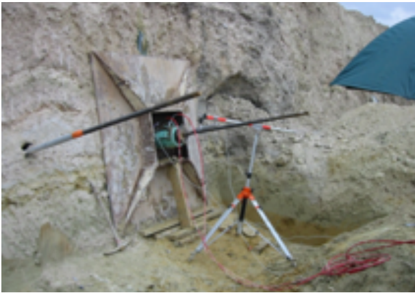
Photo 8.1b : massif de réaction en acier pour essai à la rupture (© Spie Fondations)
