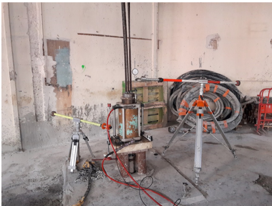
Photo I.5 : Dispositif de mesure des déplacements (© Spie Fondations)
