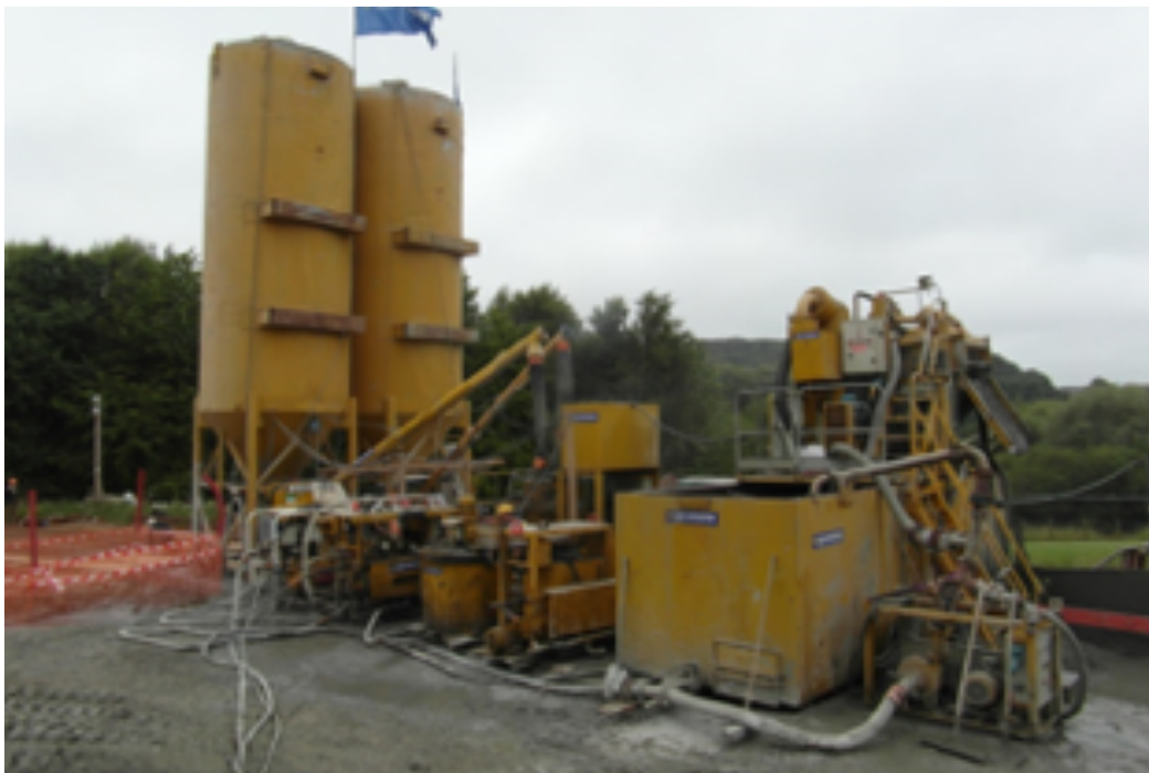
Photo 7.11 : centrale de fabrication de coulis (© Sefi Intrafor)
