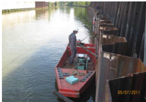
Photo 7.17 : Exemple de mise en tension de tirants sur un rideau de palplanches
