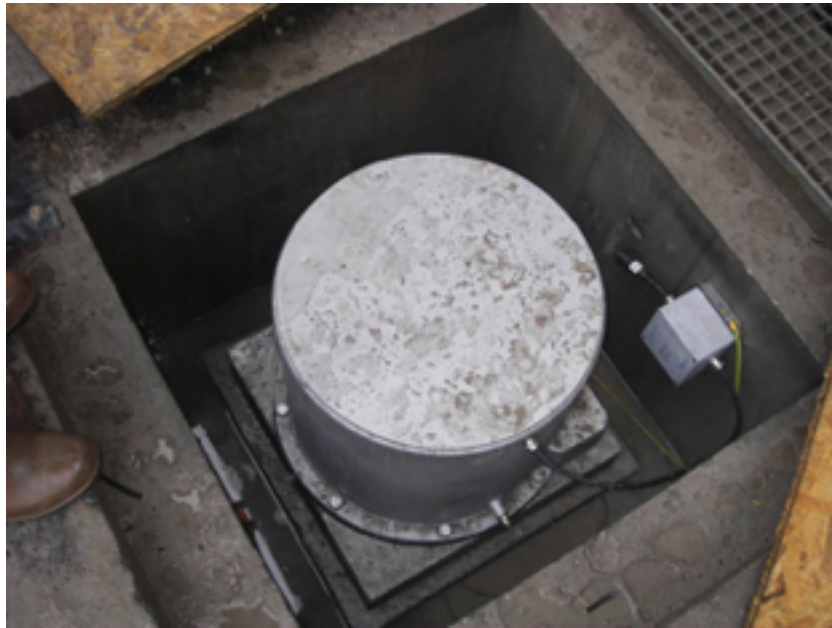
Photo 8.7 : Tête d'ancrage avec capot équipée d'un appareil de contrôle (© François Morel-EDF)
